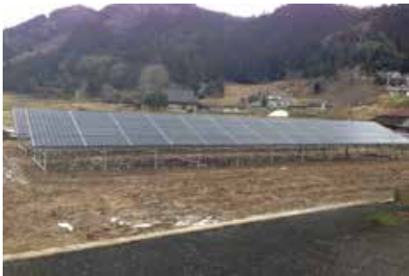
避難所とその横に設置された太陽光発電設備
