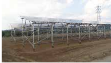
【ソーラーシェアリング 太田第一号発電所】
