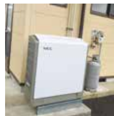
設置された蓄電池
