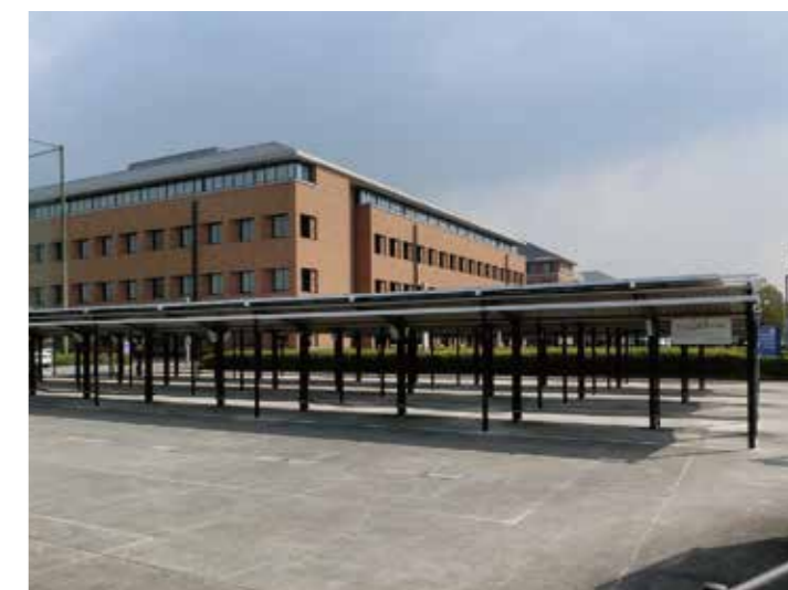
関西外国語大学駐輪場 太陽光発電システム (側面より)
