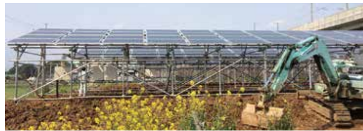
筑後市営農型許可第一号 長原田 篠原ソーラー発電所
