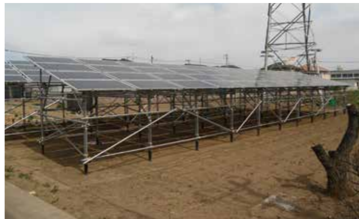
埼玉県深谷市の SOLAR 営農 (12kWx2 パック)
