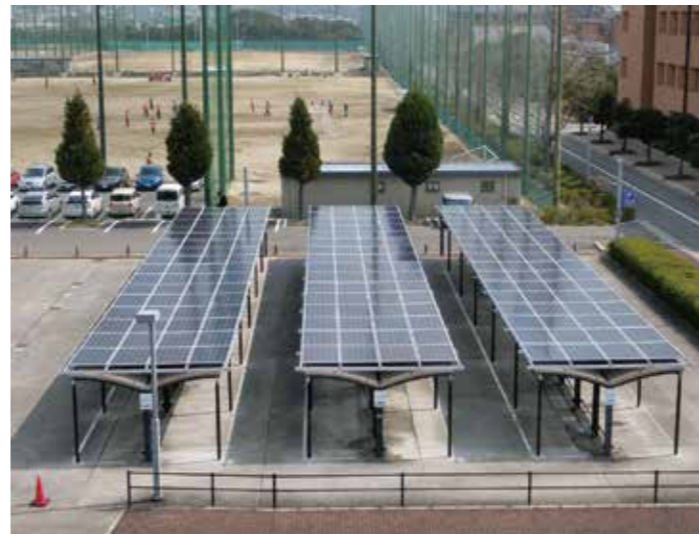
関西外国語大学駐輪場 太陽光発電システム (上部より)
