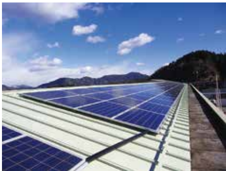
屋根に設置した太陽光パネル
