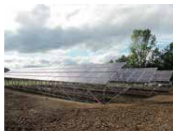
マゼラン太陽光発電所 (60kW)
