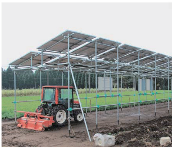
農地に支柱を立てて太陽光パネルを設置できる「SOLAR 営農」の施工例
